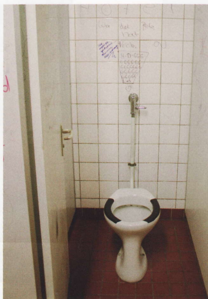
Bild links: WC vorher: rostende Heizkörper, die Flächen lassen sich kaum sauber halten.
